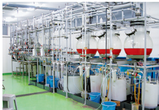
東京工場溶媒抽出設備
