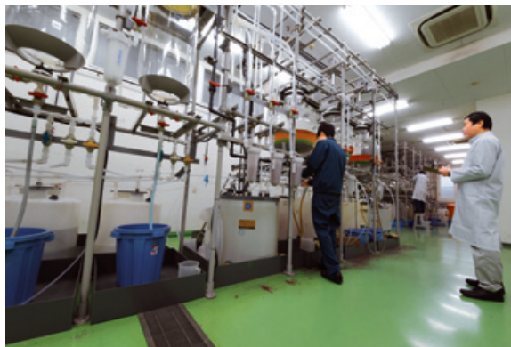
東京工場溶媒抽出設備
