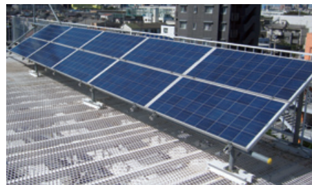
太陽光パネル
