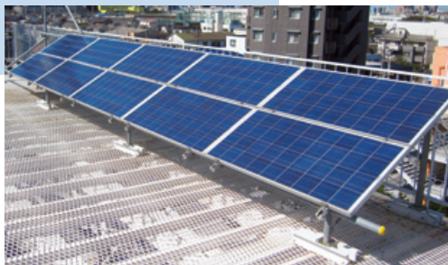
太陽光パネル
