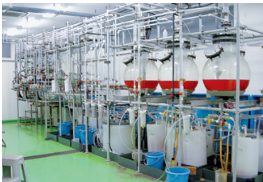
東京工場溶媒抽出設備
