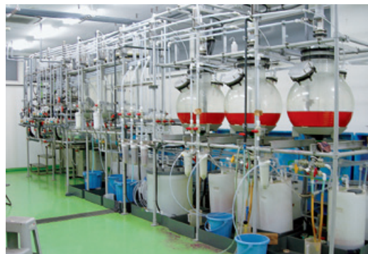
東京工場溶媒抽出設備
