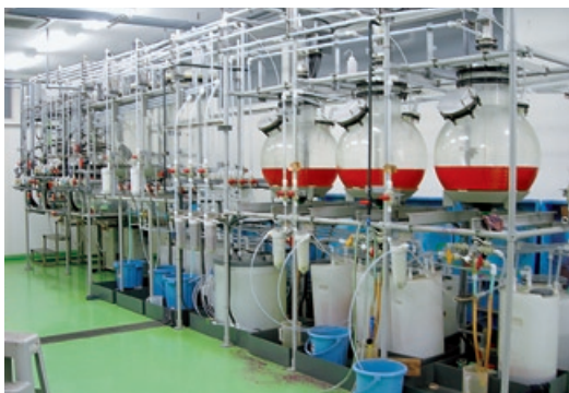
東京工場溶媒抽出設備
